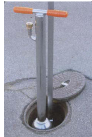
Aufgesetzter Reiniger am Hydrant
